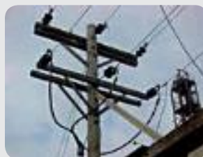
Chyba rozvodného vedení
